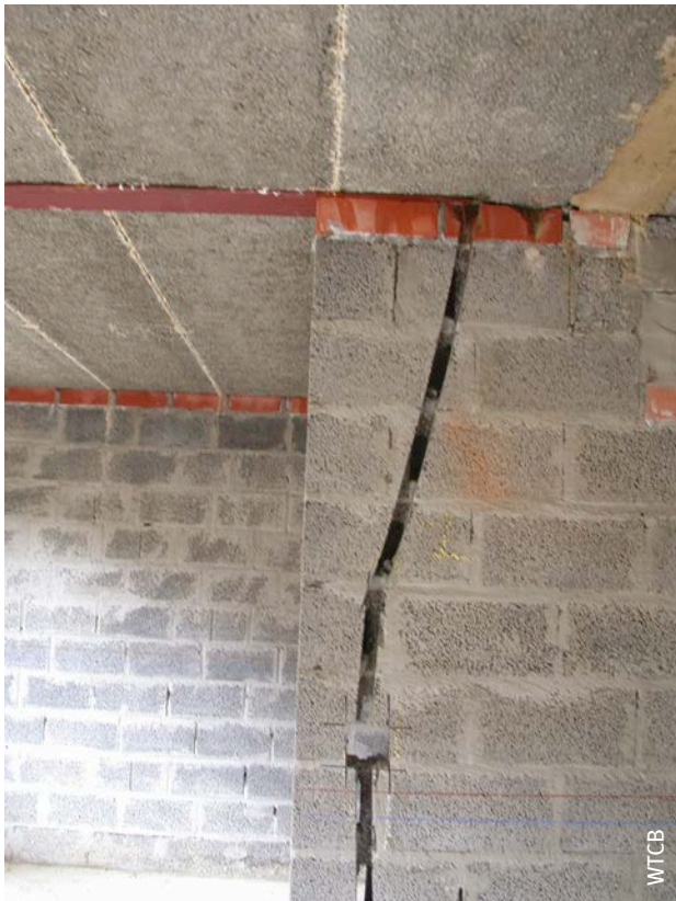
Afb. 114 Sleuf die een ontoelaatbare verzwakking vormt in het dragende metselwerk.
